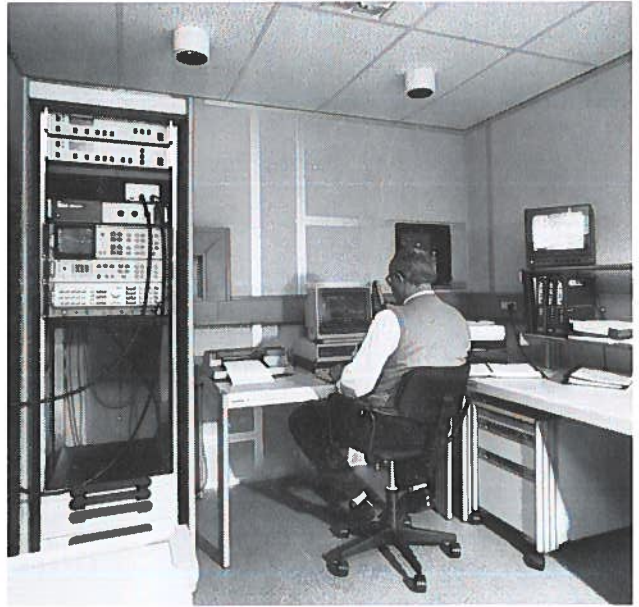
De controlekamer met meet- en besturingsapparatuur.
